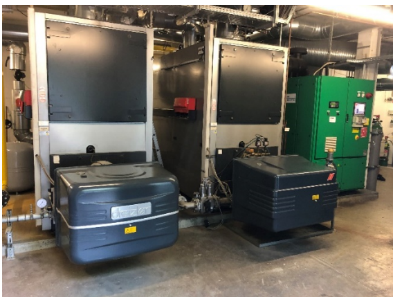
GETEC-Blockheizkraftwerk in einer von der GWG-Gruppe betreuten Liegenschaft in Filderstadt bei Stuttgart (Foto: GETEC)
